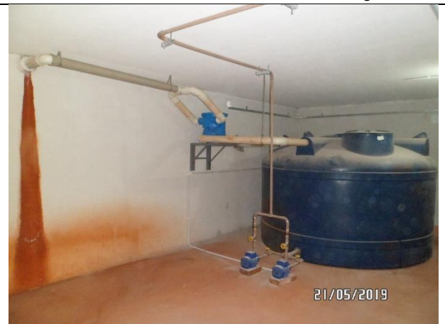
Foto 08 – Vista sistema de filtro e bombas pluvial.
