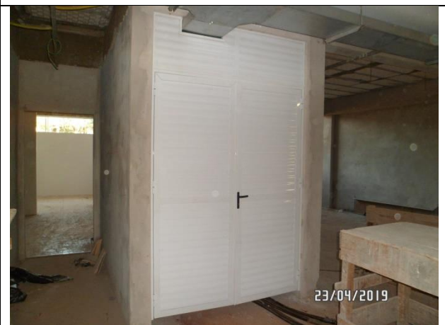
Foto 06 – Vista shaft elétrica.
